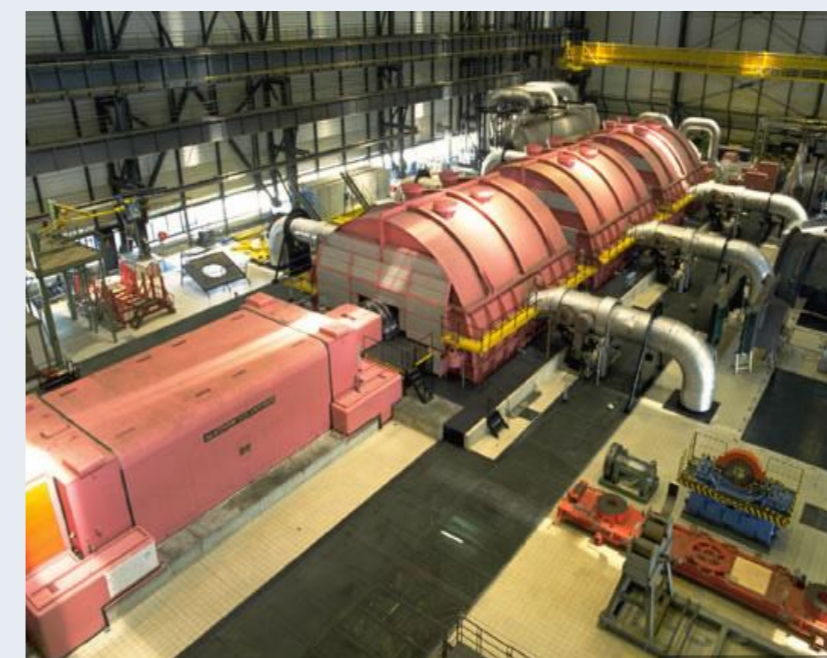
Stator dans une centrale
